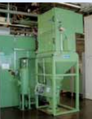
Bild 2: Absauganlage mit RINGLER-Doppelschiebersystem und Druckluftspeicher
