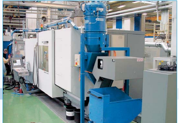
RI 750 mit Rohrleitung und Saugstelle
